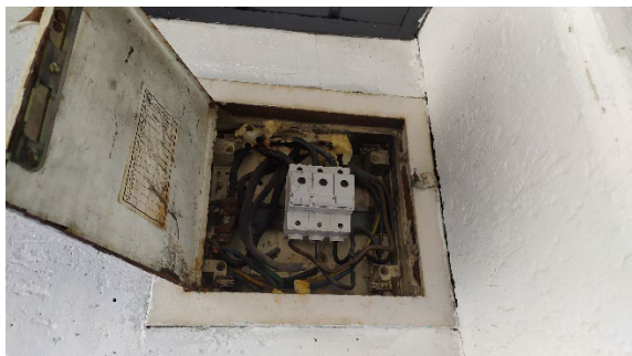
rys. 1 istniejący wyłącznik główny; do demontażu i zabudowy nowej skrzynki pośredniczącej
